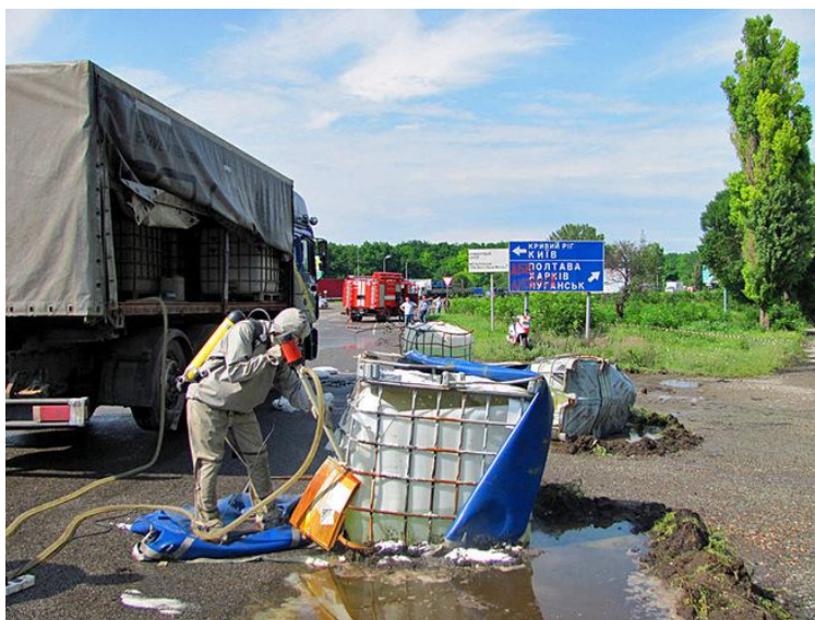
Рис. 2.5. Перекачування кислоти із пошкодженої ємності
